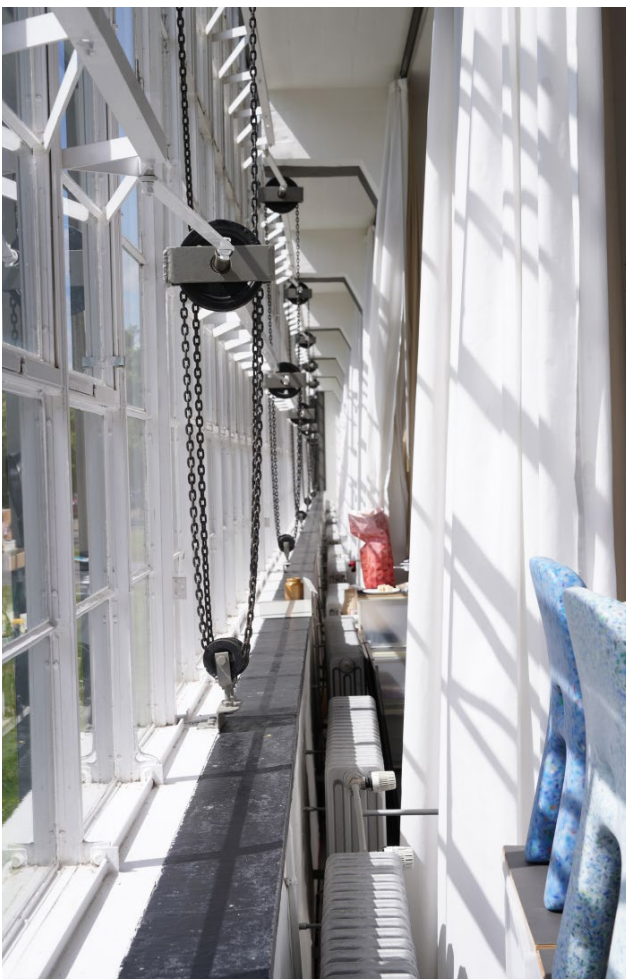
Bild 2. Glasvorhangfassade der Werkstatt von innen, mit mechanisch gesteuerten Lamellenflügeln zur Lüftung
